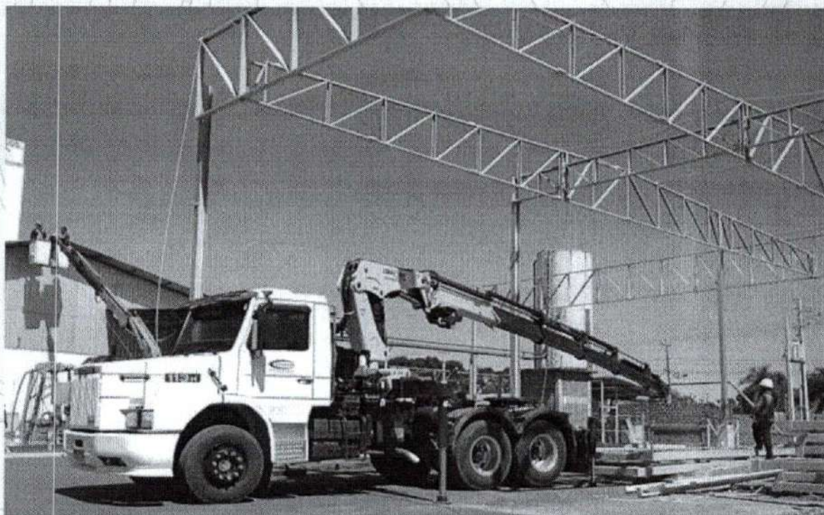
Demarcação e acompanhamento de Estrutura Metálica realizado no Frigorífico e Abatedouro de Aves da empresa Dip Frangos s/a.
